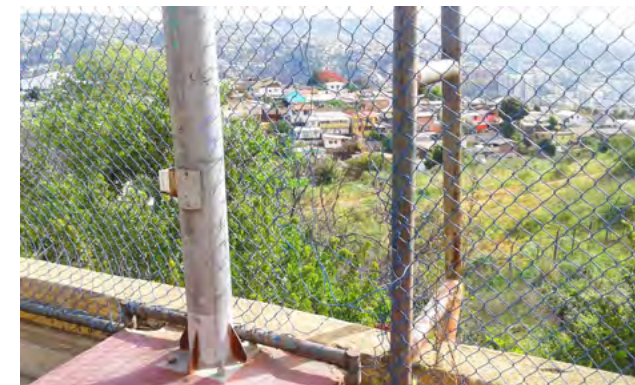
Rejas perimetrales de multicancha en mal estado
